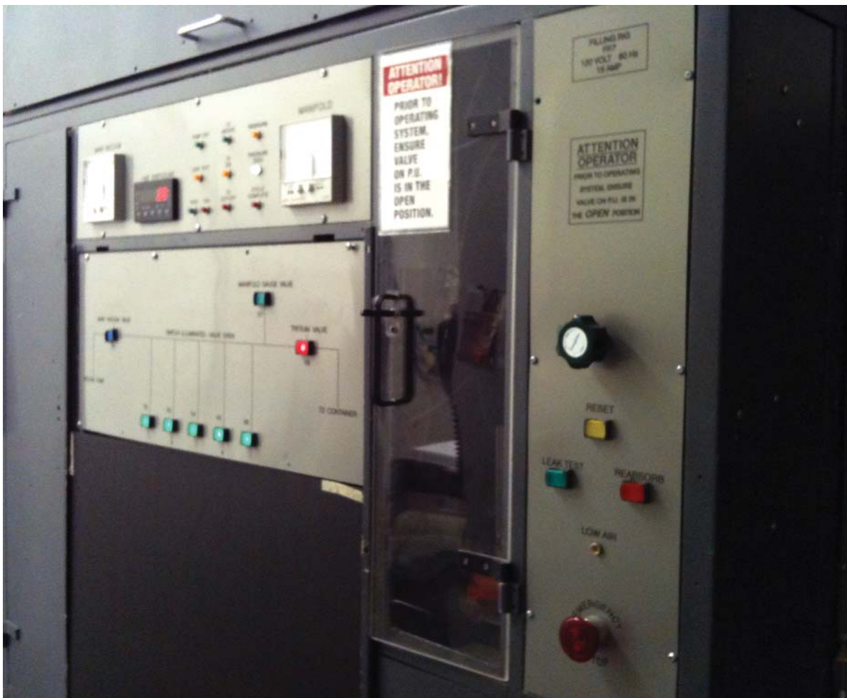
Un appareil de remplissage typique est utilisé pour remplir les tubes de verre avec du tritium gazeux dans une installation de sources lumineuses au tritium gazeux.
